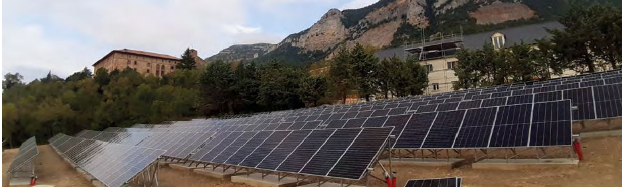
Instalación fotovoltaica de Leyre.
